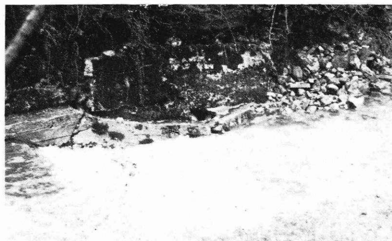
V času deževja in poplav konec januarja je Jesenica nevarno načela oporna zidova nekaj deset metrov niže od mostu pri kinu Plavž. Oba porušena zidova bo treba čimprej popraviti, ker bi sicer lahko vsako naslednje neurje ogrozilo novo šolsko poslopje na Plavžu. (Tekst in foto B. Blenkus)
