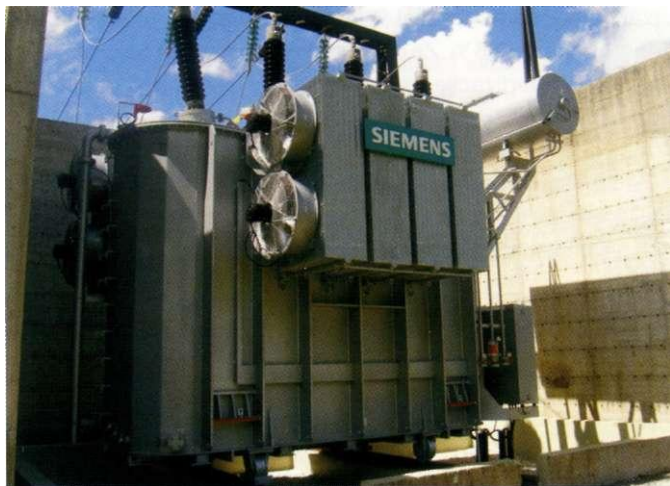
Nov 100 MVA transformator za potrebe EOP
