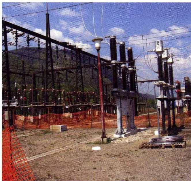
Zaključujejo se tudi dela v 110 kV stikališču, ki potekajo vse od jeseni 2005.
