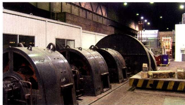
Del stare generatorske grupe.
