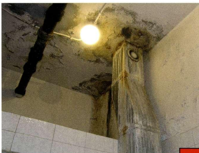
Stranišče je bilo res potrebno sanacije.
