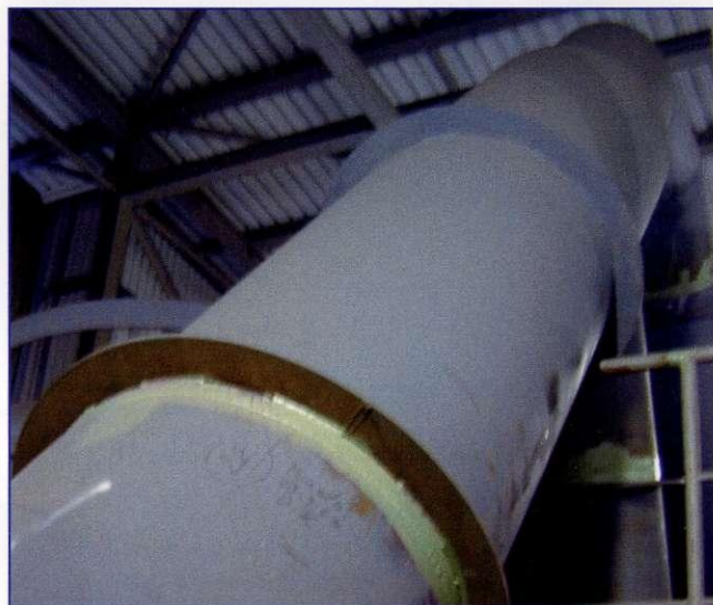
Cevi za hlajenje plinov in odpraševanje obeh VOD naprav.
