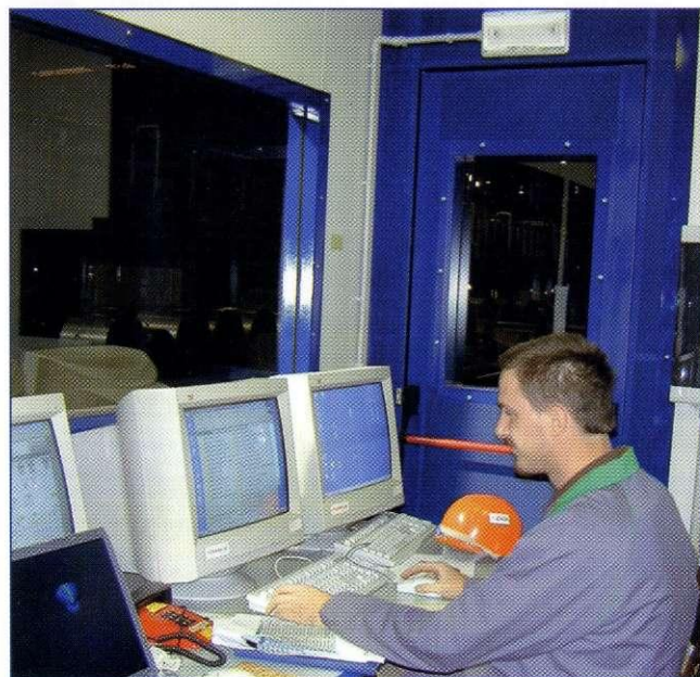
Kontrolna kabina, srce nadzora nad delovanjem linije CRNO.
