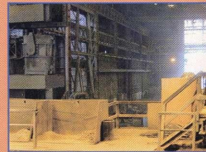
Še vedno manjka del ograje.
