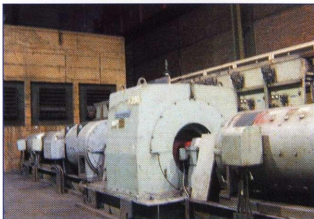
Generatorska skupina, ki je predvidena za zamenjavo.
