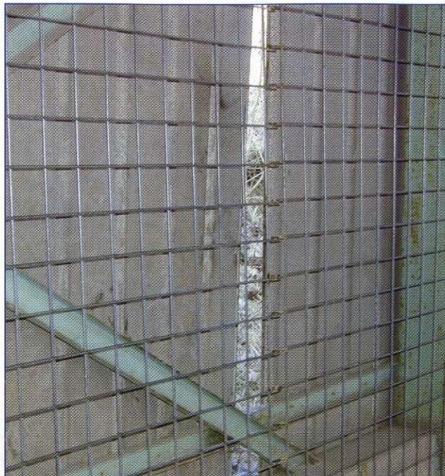
Odmaknjena aluminijasta polšča pri nastrešku Hladne valjarne, kjer so sedaj z notranje strani privarjene mreže. "Arest", so komentirali delavci iz bližnje delavnice.
