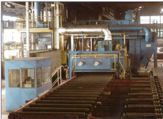
Nova peskalno – lakirna linija.
