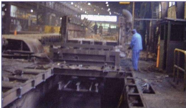
Strop in stene peči so že podrti.
