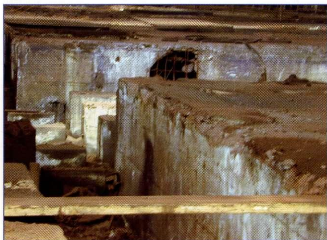
Tudi takšni prehodi preko kanalov v opuščeni Žični valjarni predstavljajo veliko nevarnost.
