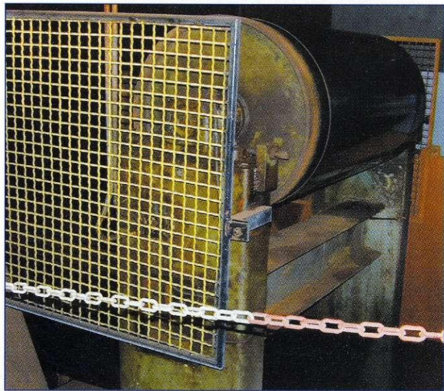
Zaščitna mreža in označevalna veriga preprečujeta poseg v nevarno območje.
