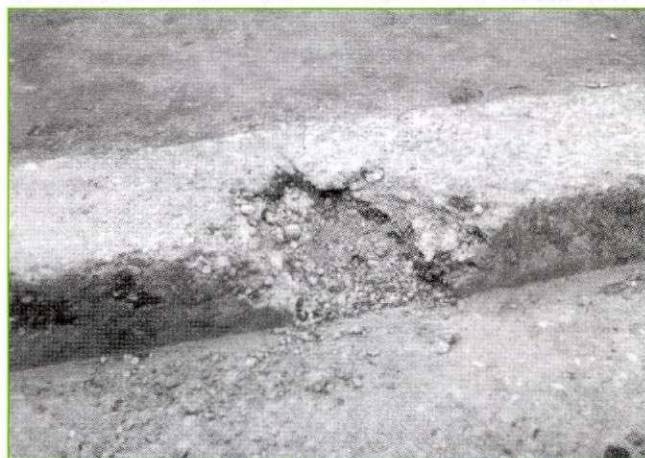
Ali čakamo, da nas bo kdo tožil zaradi poškodbe (stopnice pred glavnim vhodom na Javorniku)?
