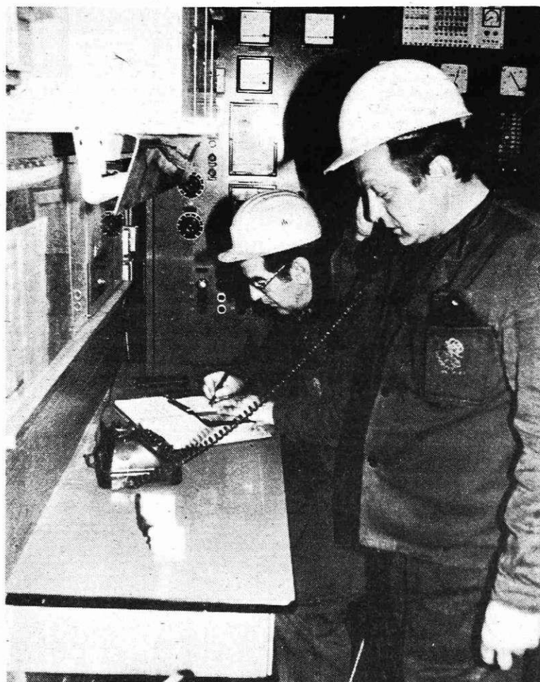
Sodelavca v komandni kabini ASEA električne peči (Foto I. Kučina)
