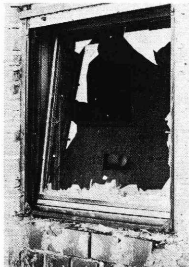
Od toče poškodovano okno
