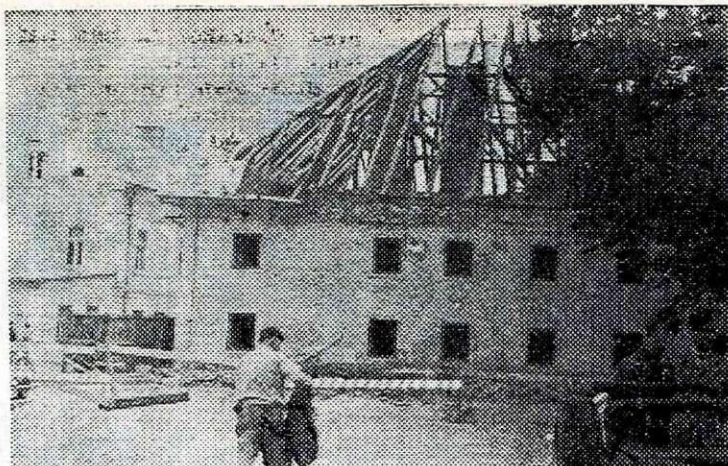
V Kranjski gori so pričeli z rušenjem nekdanjega sodišča, kjer bodo uredili parkirišča. Iz stavbe so morali preseliti šest družin.
