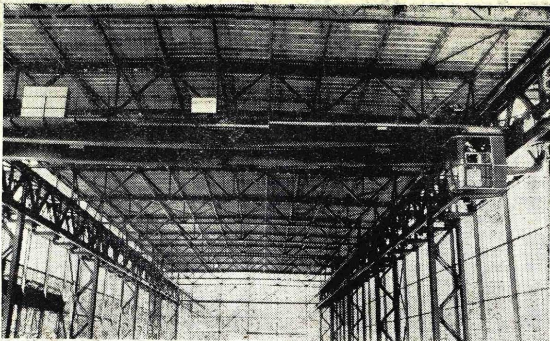
V hali, kjer bo imel svoje prostore obrat jeklovlek so pred kratkim montirali 12,5 tonski žerjav, ki je bil izdelan v tovarni Litostroj v Ljubljani
