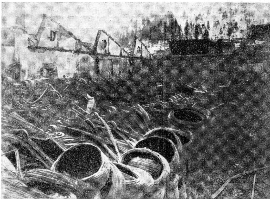
Skladišče gotovih izdelkov za odpremo in zavijalnica žebeljv po požaru. V ozadju zidovi predelovalnih obratov
